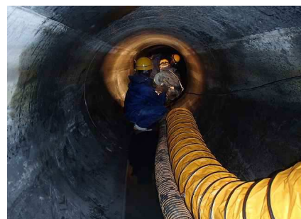
硫化水素濃度60ppm！換気がストップしたら・・・。
