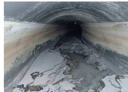
散乱した土砂、汚泥が配管内に蓄積
